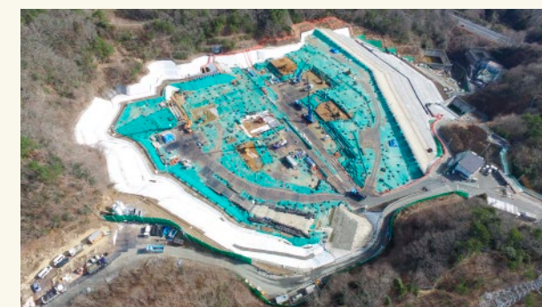
特定廃棄物埋立処分施設（富岡町）
