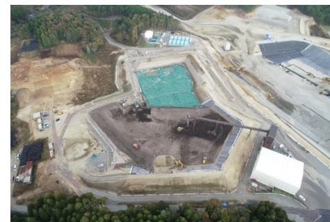
土壌貯蔵施設(双葉①工区)
